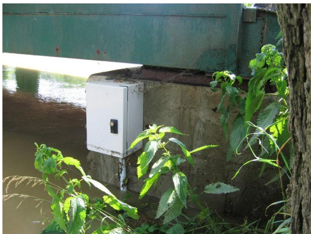
Obr. č. 19 Chybná instalace měřicí stanice (ve spodní části měřicí stanice je vidět pozice maximální dosažené hladiny)
