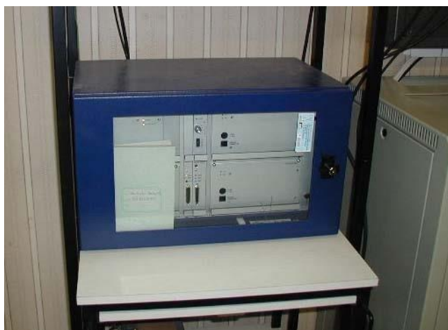
Obr. č. 21 Vysílač je umístěn v objektu u stožáru
