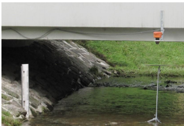
Obr. č. 10 Chybná instalace ultrazvukové sondy.
